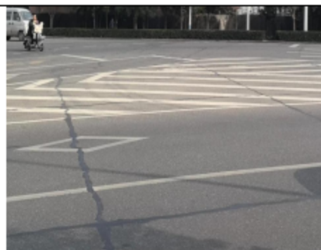
现状道路存在裂缝
