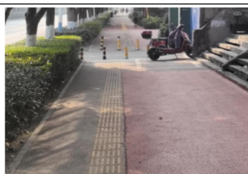
现状人行道开裂、盲道部分损毁
